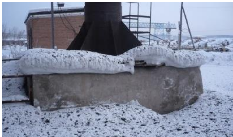
Рис. 1. Вынос несгоревшего топлива из дымовой трубы
