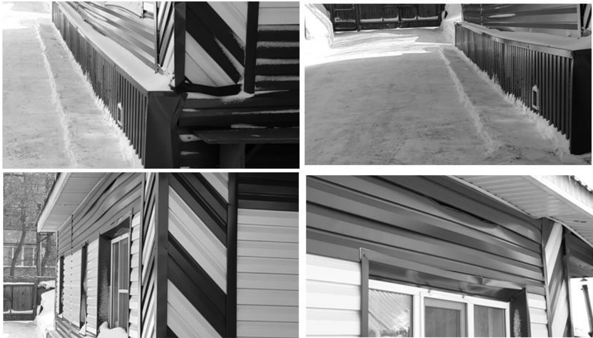
Рис. 2. Деформации конструкций дома
